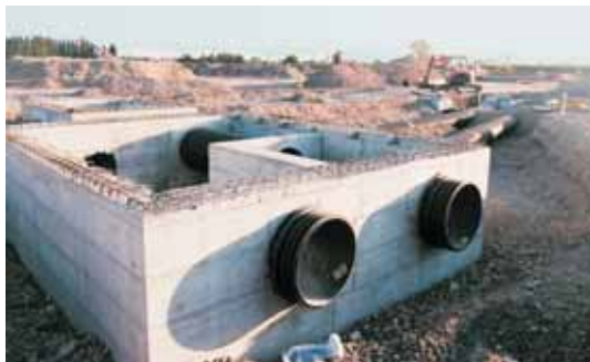
IMPIANTI PRIMA PIOGGIA
